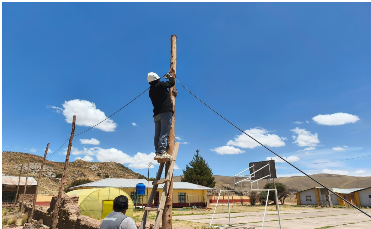
Fotografía de la actividad 4: Alimentación eléctrica al salón 3
