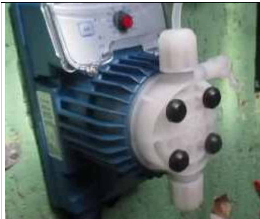
Sistema de dosificación de cloro – Vista de bombas dosificadoras utilizadas para precipitación de hierro, con signos de corrosión y deterioro
