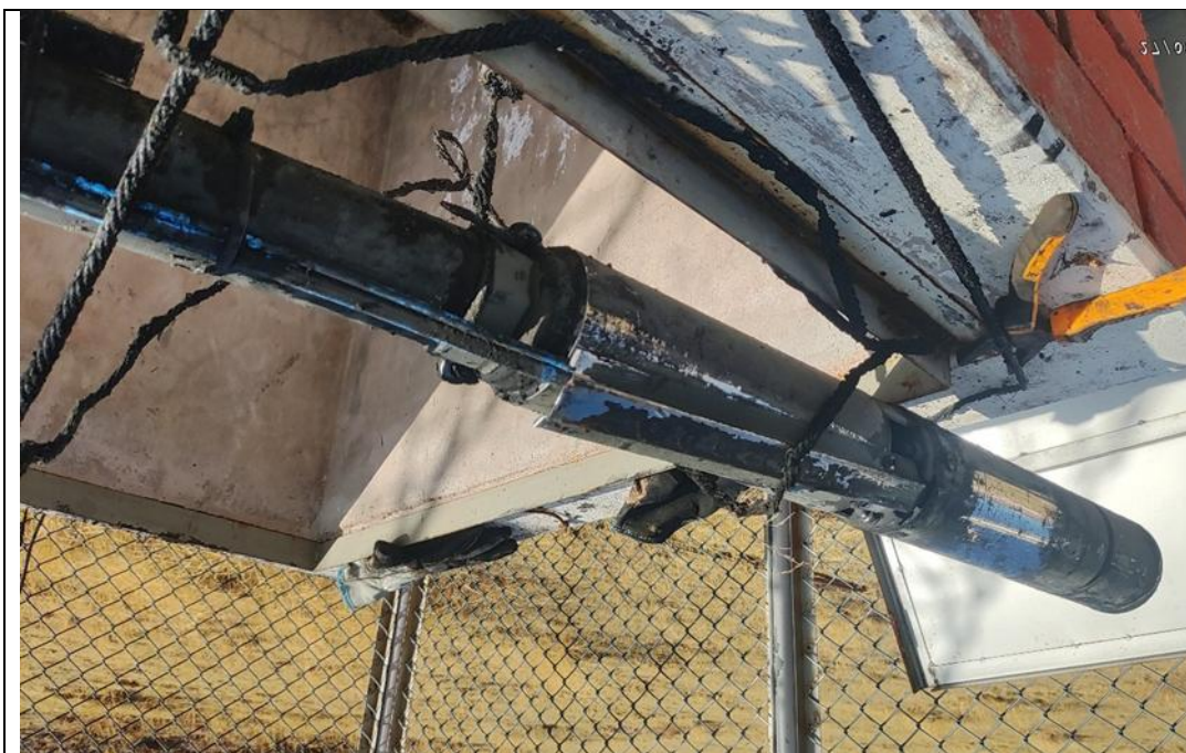
Vista del punto de ingreso de agua al sistema de tratamiento, donde se inicia el proceso de potabilización, evidenciando desgaste en equipos de bombeo.
