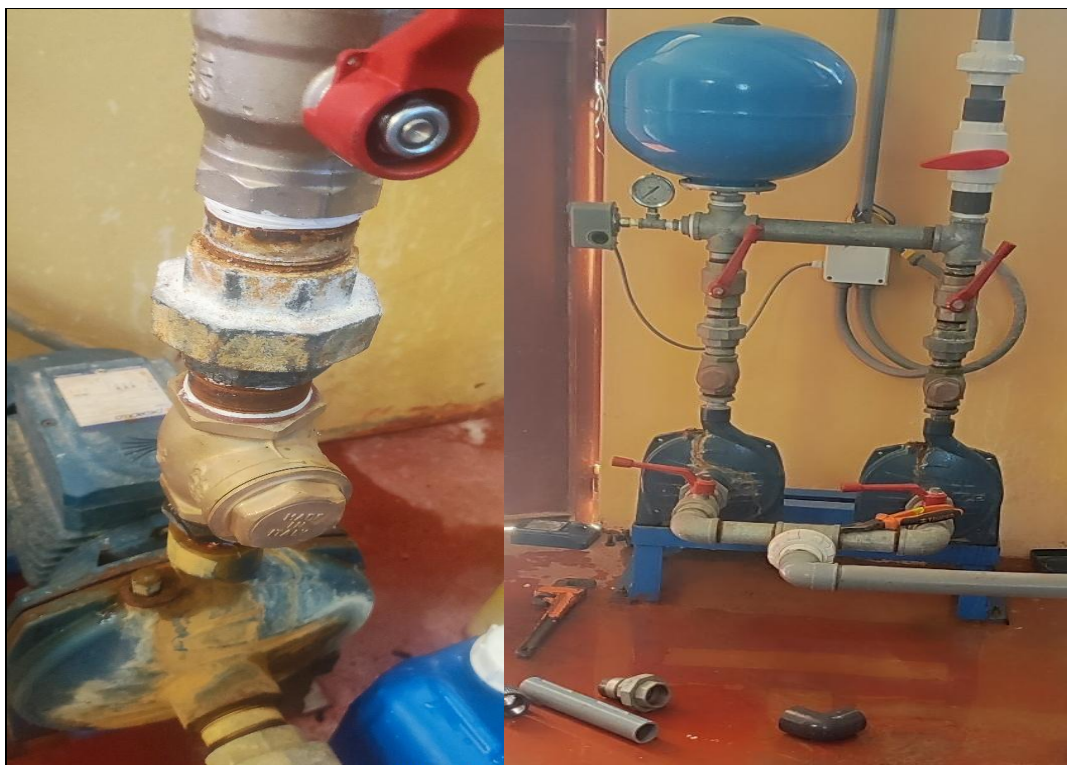
Electrobombas Pedrollo de 4 HP – Fotografía de las bombas de captación alternadas, mostrando vibraciones y fugas por desgaste y estado de los accesorios y válvulas antirretorno.
