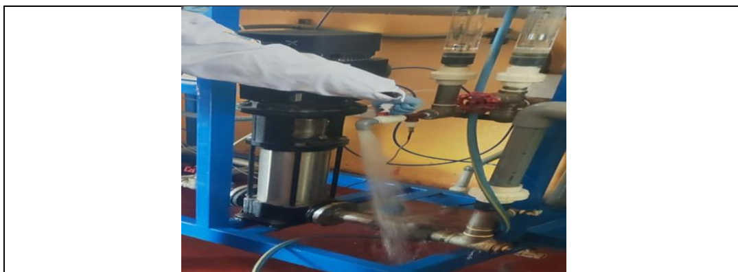
Bombas de alta presión (300 psi) – Fotografía del sistema de impulsión hacia ósmosis inversa, evidenciando desgaste en accesorios.
