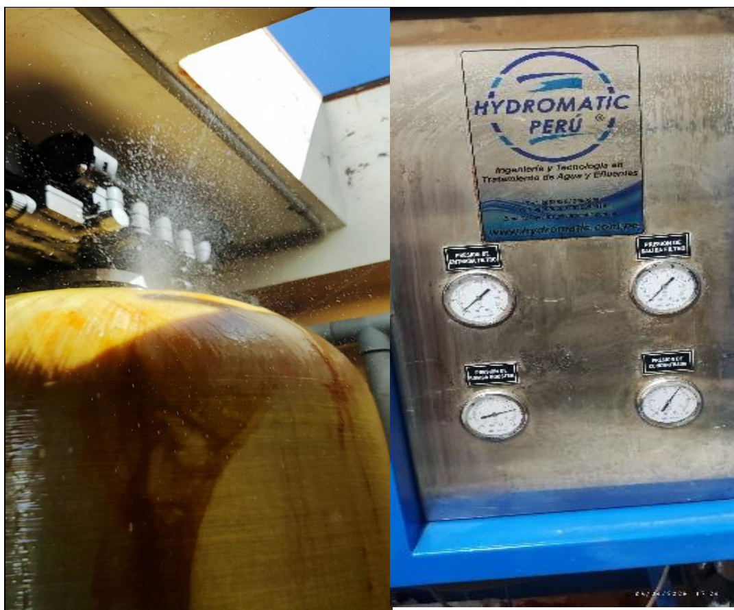
Imagen de los filtros de alta presión y sus respectivos nanómetros para constante monitoreo de presión
