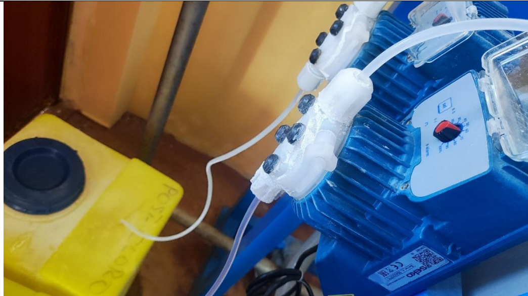
Cloración final del agua tratada – Imagen de bombas dosificadoras para desinfección, con necesidad de mantenimiento y reposición de insumos.
