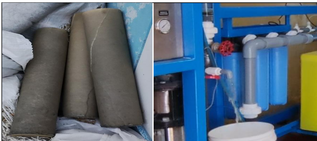
Filtros de cartucho pulidores – Imagen de los cartuchos de polipropileno de 5 micras, colmatados y con pérdida de presión.
