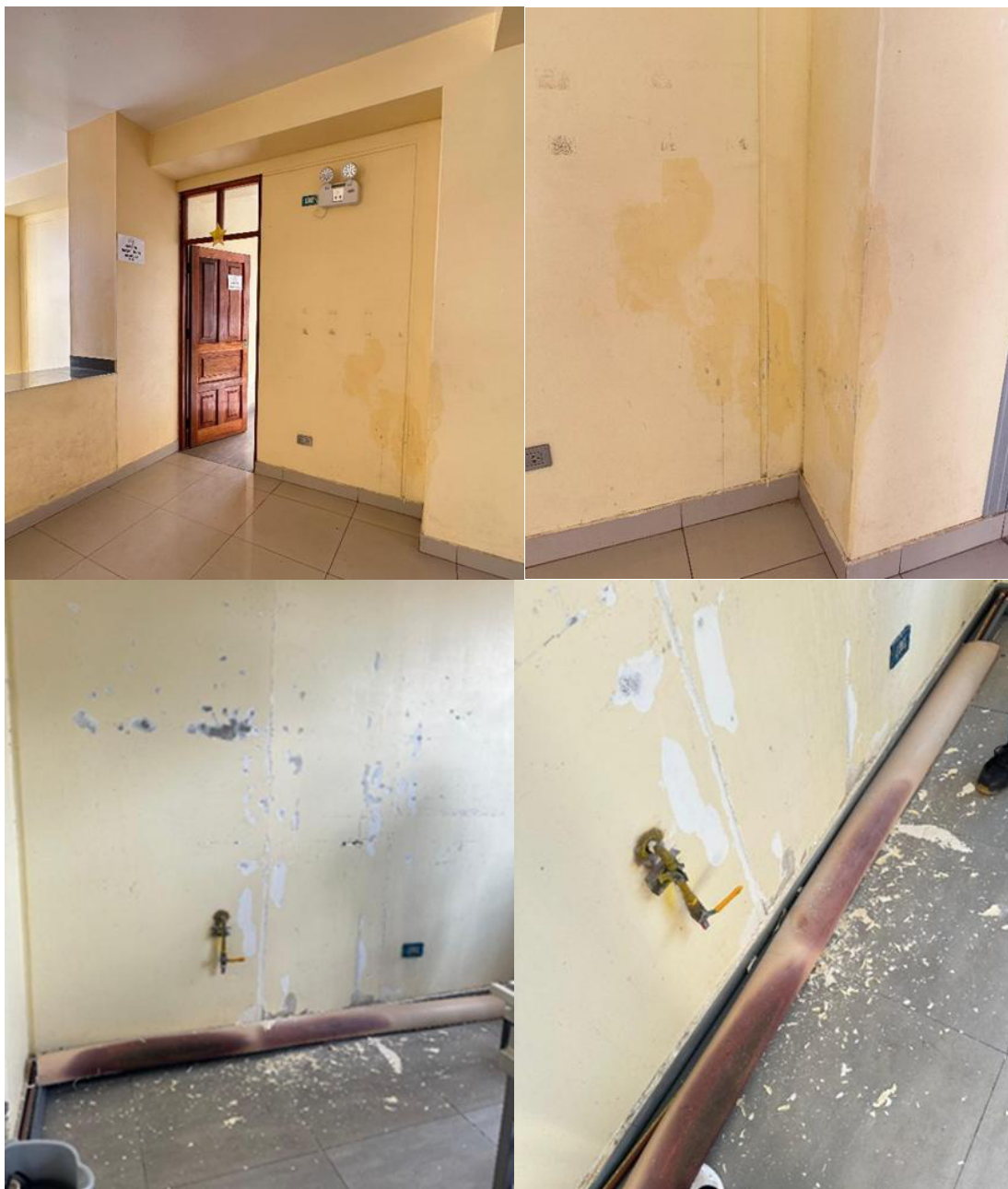
Figura 5 Estado de los muros interiores
