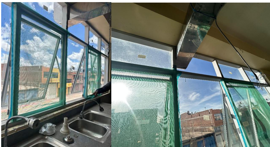
Figura 10 Ventanas no cuentan con mosquitero adecuado
