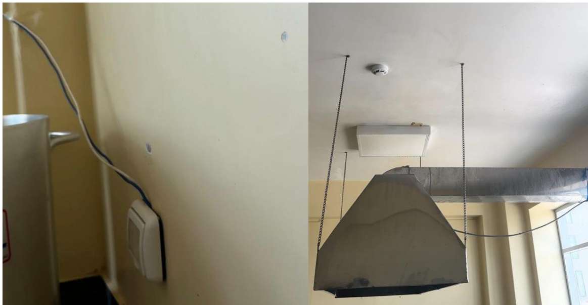
Figura 14 Estado de conexiones eléctricas improvisadas
