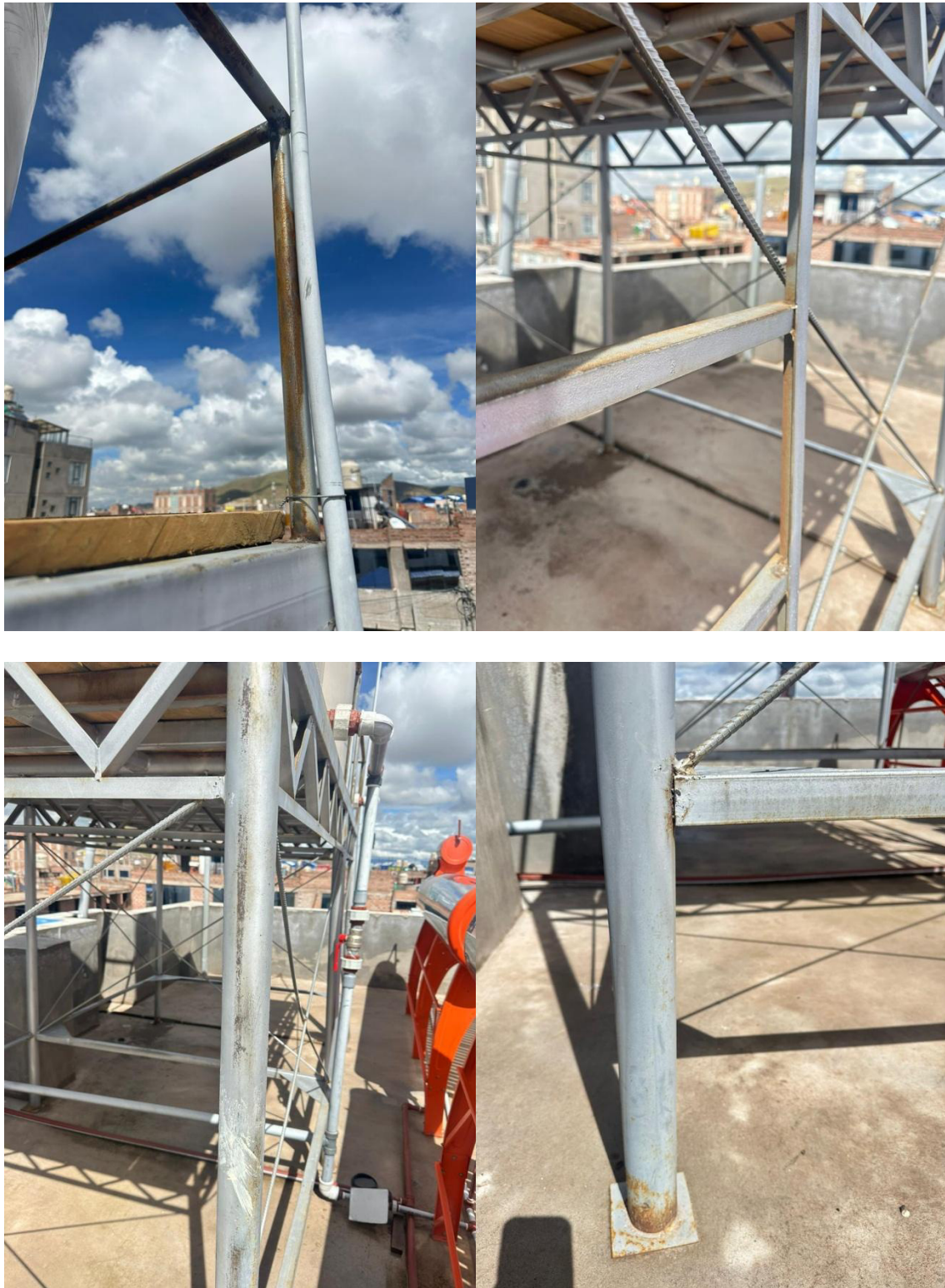
Figura 1 Estado de los elementos del tanque elevado
