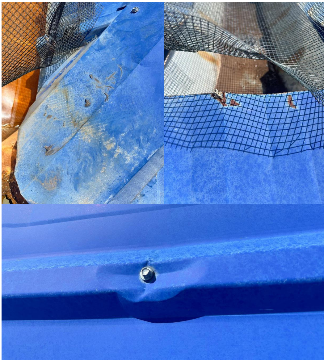
Figura 4 Estado de la cobertura
