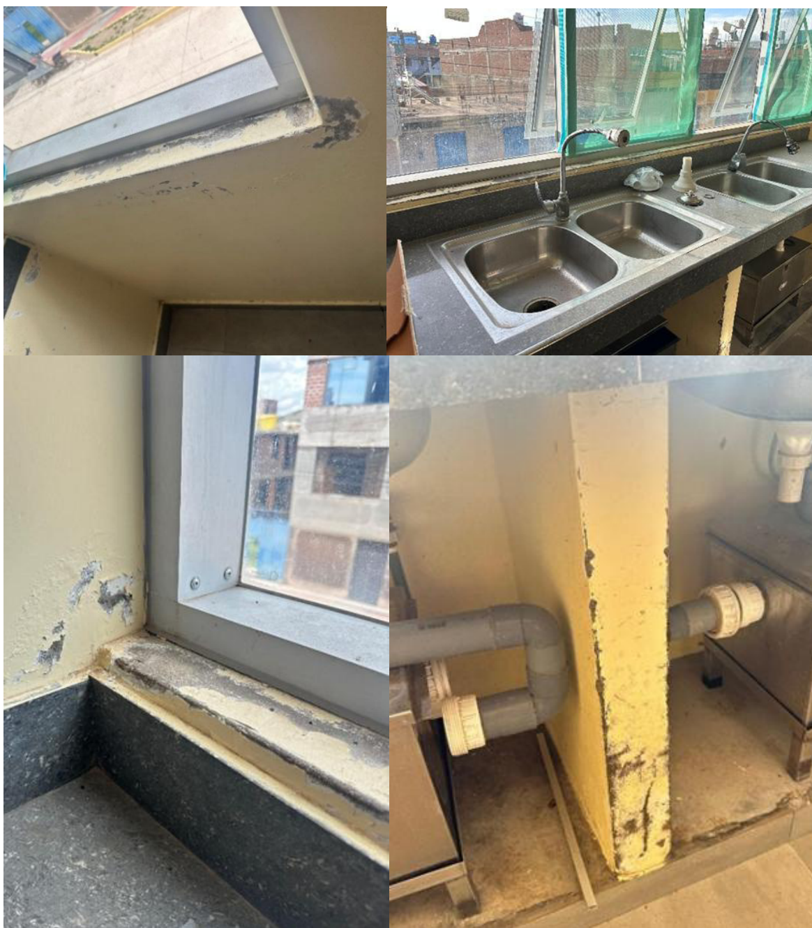
Figura 7 Estado de enchapes
