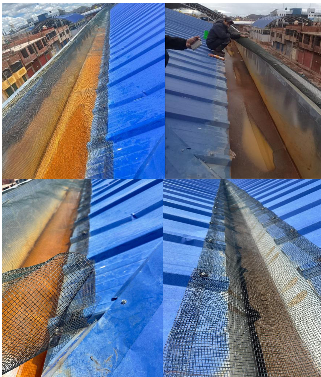
Figura 2 Estado de las canaletas
