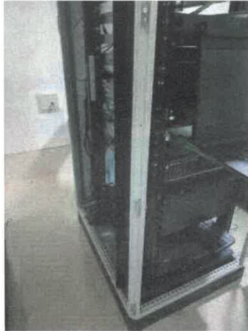
Fotografía 2 – Gabinete de Comunicaciones
